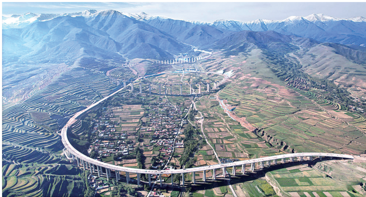
这是10月10日拍摄的建设中的青海乐化高速公路斜沟5号特大桥一角。
