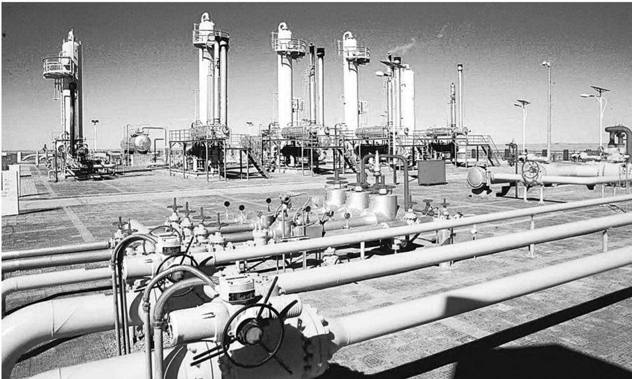
青海油田油气管道。
