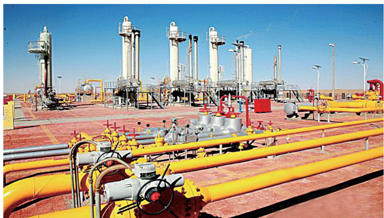
图为涩北气田集气站。
