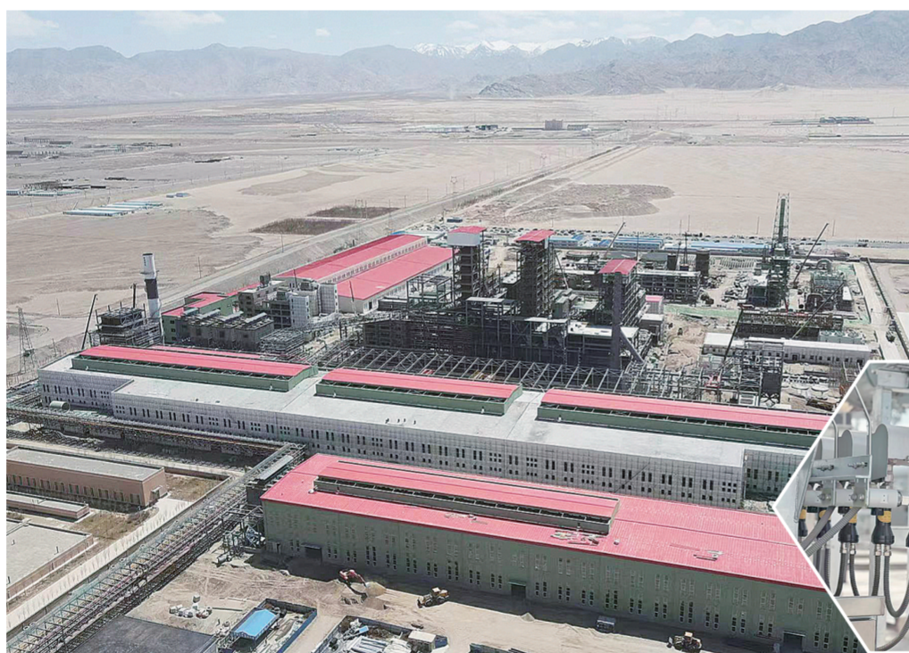
青海西豫有色金属有限公司多金属资源综合利用及环保升级改造项目现场。
