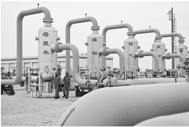
2023年2月6日，输气工在塔里木油田西气东输第一站装置区进行巡检。新华社记者 李响 摄
