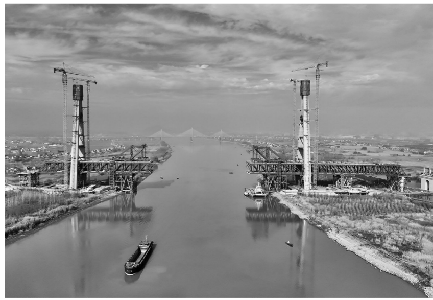
这是巢马城际铁路马鞍山公铁两用长江大桥副汉航道桥主塔封顶施工现场(12月26日,无人机照片)。
