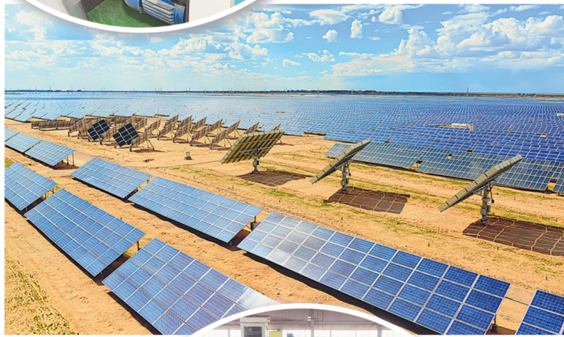
↓格尔木东出 口光伏产业基地
